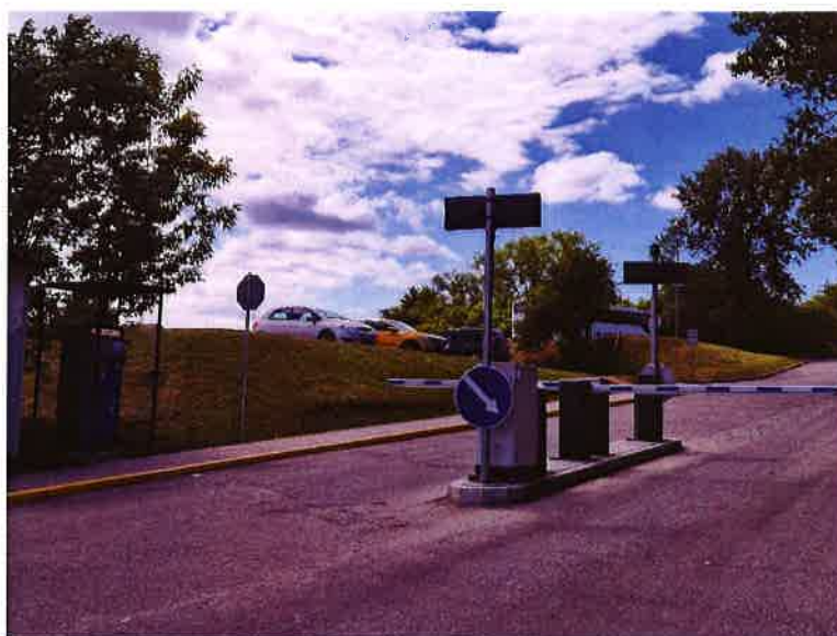
20 pav. Automatinė parkavimo kontrolės sistema
