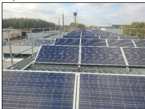
8 pav. Bendrovės saulės elektrinė
