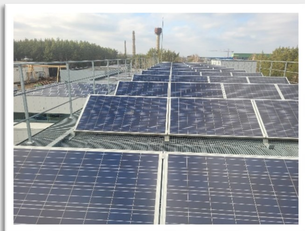
8 pav. AB „VIAMATIKA“ saulės elektrinė
